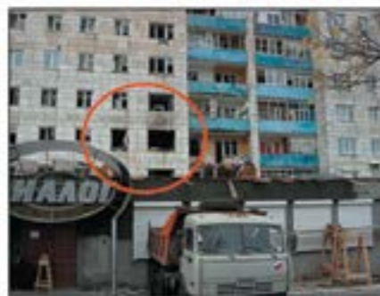
Рис. 11. Взрыв в жилом кирпичном доме с указанием расположения помещения кухни в г. Губаха Пермского края
